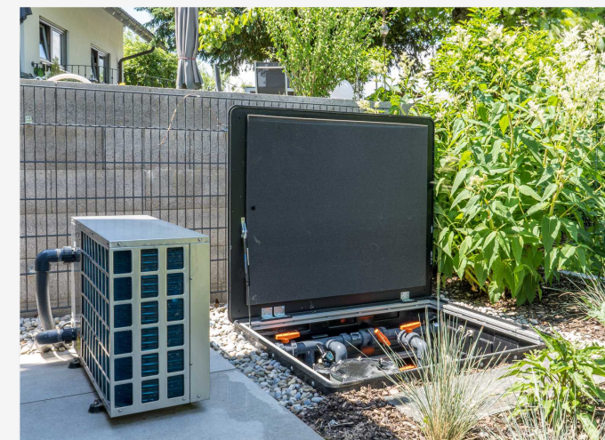
Tepelné čerpadlo a čerpadlová šachta umístěná mimo terasu.
